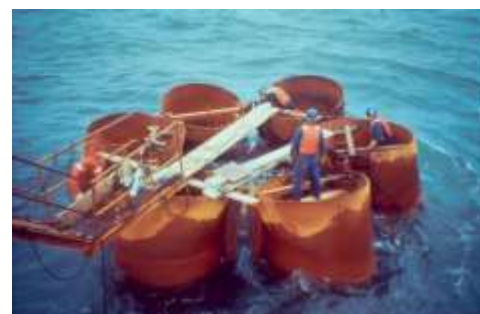
Construction des piles sur pieux en béton battus et forés à large diamètre pour les travées d'approche (1994-1995).
