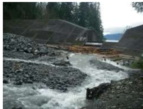
Structure à la suite de la coulée de débris de 2009, avant que les débris ne soient retirés (échelle : la largeur de l'ouverture de l'évacuateur de crue est d'environ 8 m).
